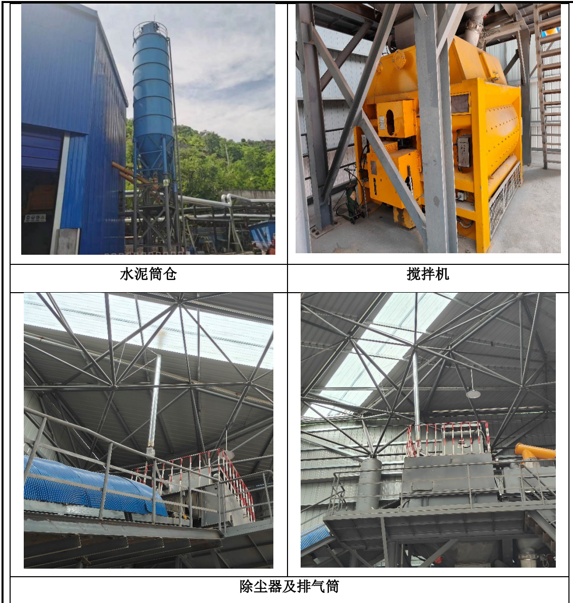
图 3-2 废气处理设施
